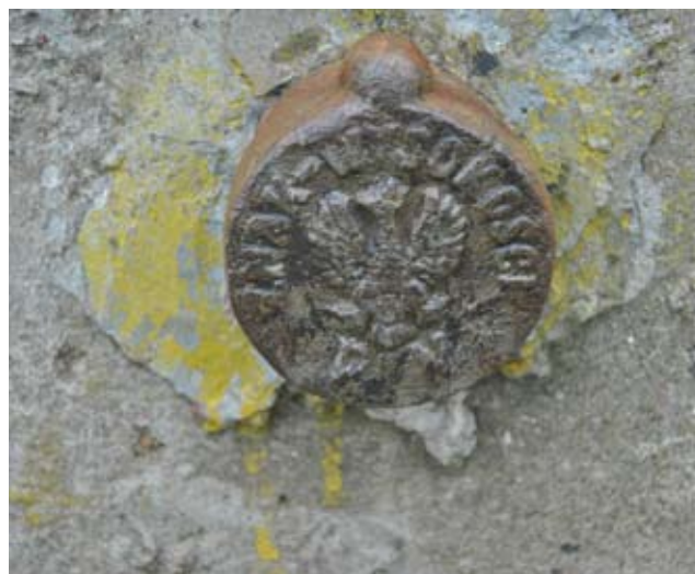
Boleć repera przy ul. Warszawskiej w 2012 po oczyszczeniu
